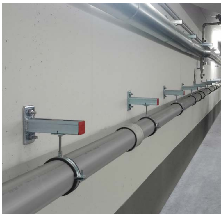
Hoher Befestigungsaufwand bei einer Kunststoffrohrleitung
